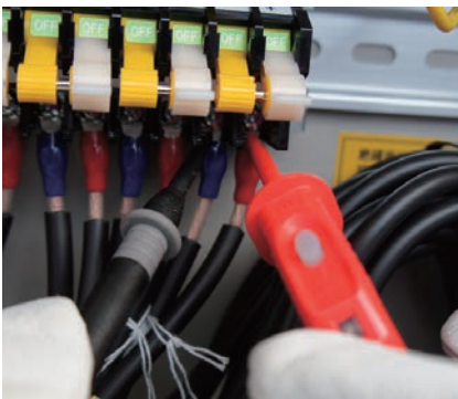
无需遮光在汇流箱即可进行检查
